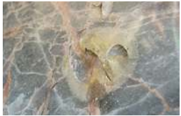
ウレタン塗装が劣化し剥がれた例（弊社商品はポリウレタン塗装をいたしておりません。）
